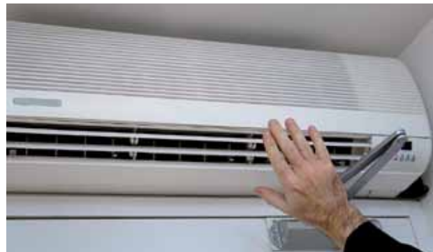
La fluctuation autour de la température programmée peut atteindre \pm 2^{\circ}\text{C} pour un climatiseur classique, elle est d'environ \pm 0,5^{\circ}\text{C} pour un climatiseur Inverter, ce qui procure une sensation de confort plus grande.
