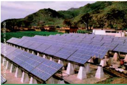
Centrale solaire de Kankoy (Pakistan) - 70 kWc.
