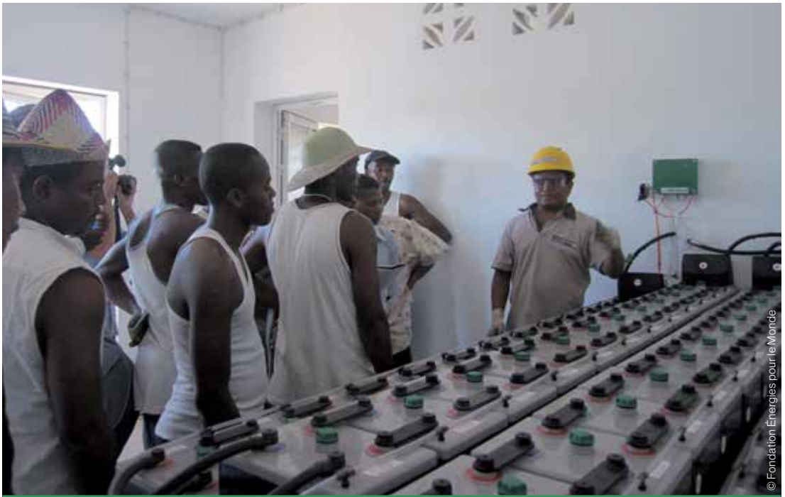
Technologies de stockage Les batteries d'une minicentrale solaire de Madagascar
