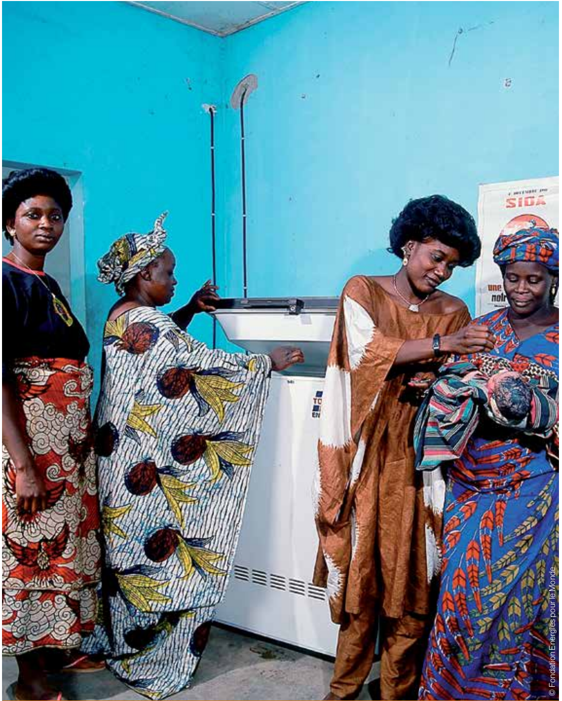
Centre de santé électrifié au Burkina Faso.
