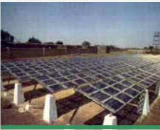
Générateur solaire de l'hôpital de San (Mali) - 10 kWc.
