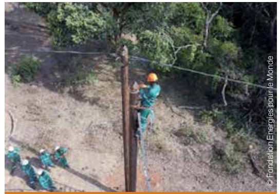
Miniréseau basse tension en Guinée.
