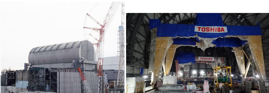
Figure 2 : Vue de la structure recouvrant le bâtiment du réacteur n°3 (état en février 2018) et des moyens de manutention du combustible qui y sont implantés - Source TEPCO.
