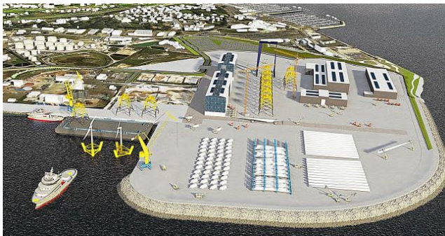
Travaux en cours pour la réalisation d'un polder sur le port de Brest visant à attirer les activités liées aux énergies marines
