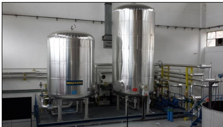
Figure 3- 69 : vue d'une installation d'essais en fluide simulant de thermohydraulique lors des essais de réception
