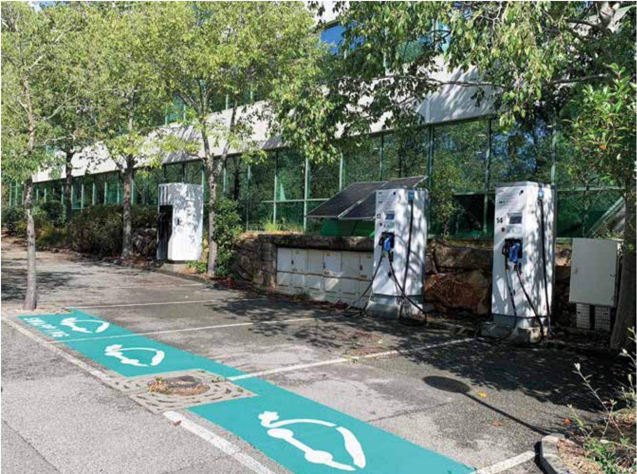
Bornes de recharge sur le parking de l'entreprise SAP à Mougins
