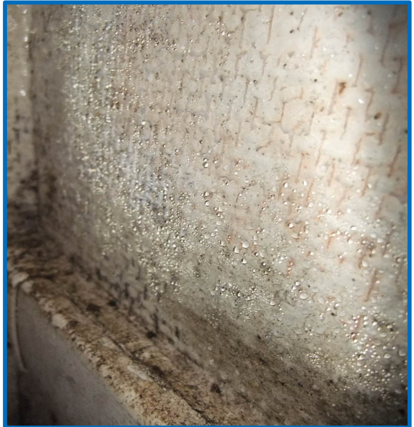
Condensation d'air chaud et humide sur une paroi froide dans une chambre quotidiennement aérée
