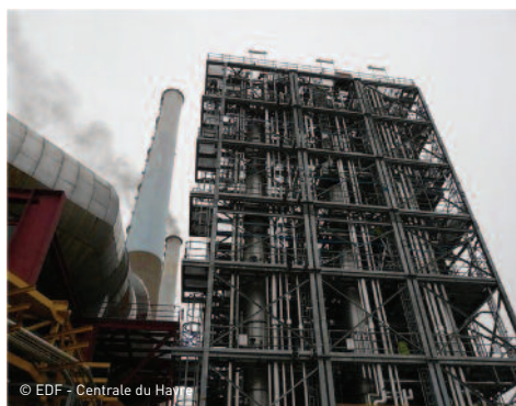
© EDF - Centrale du Havre
