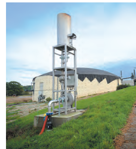
La torchère est mise en fonctionnement pour des raisons environnementales et de sécurité lorsqu'il faut détruire le biogaz.
